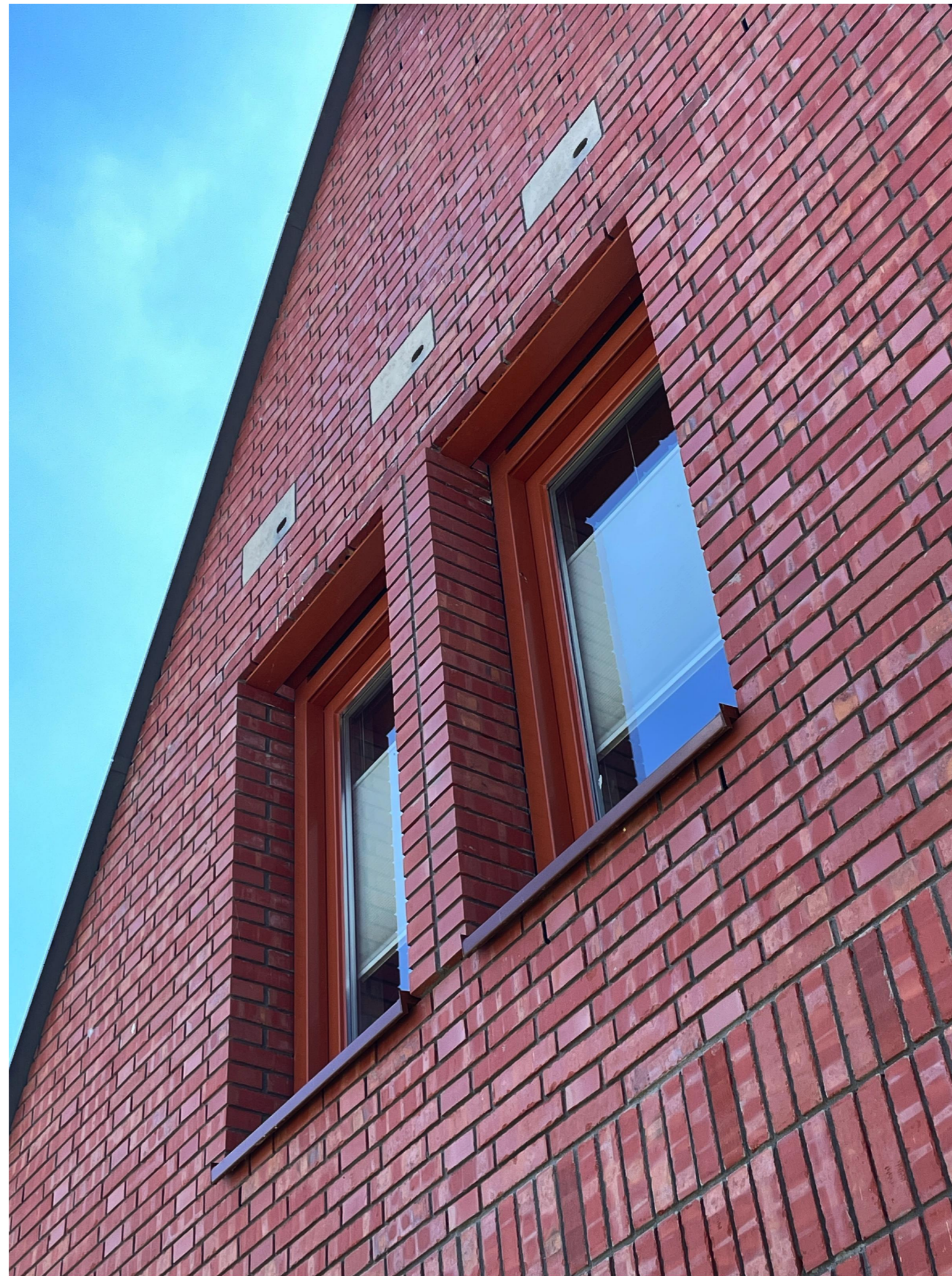
▲ Strak uitgelijnd kettingverband en een diversiteit in vlakken en verbanden zijn een ode aan de Groninger baksteenindustrie en het vakmanschap en ambacht van het metselen. Een strakke stalen windveer levert een subtiele schaduwrand en is een eigentijdse beëindiging.
